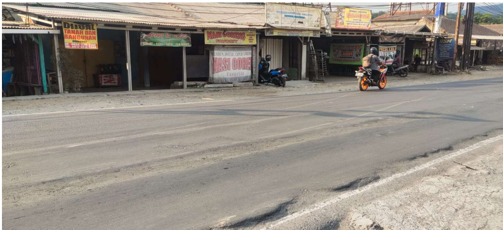
Gambar 2 Kerusakan Jalan Di Ruas Jalan Prabu gajah Agung
